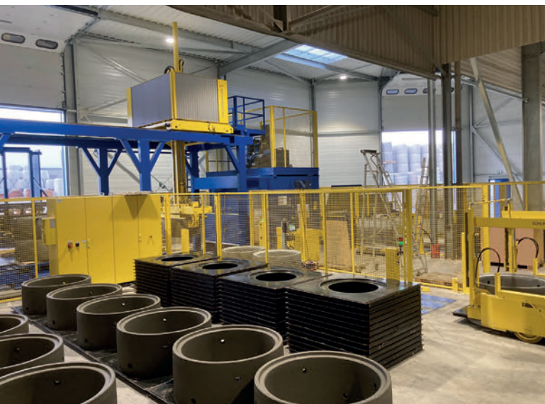
Vue sur le Palettiseur situé dans l'extension de bâtiment
